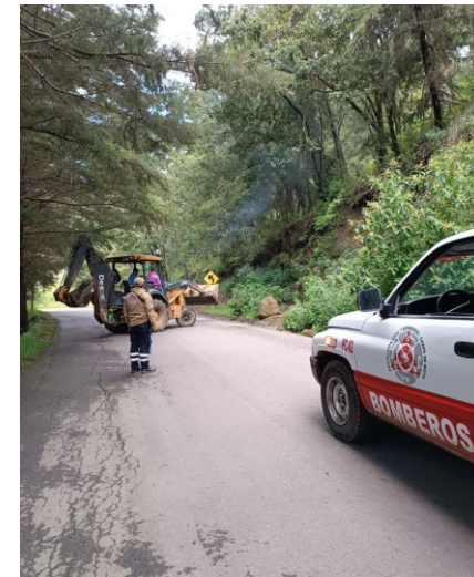
Imagen 13 Removiendo material detrítico por movimientos gravitacionales.
